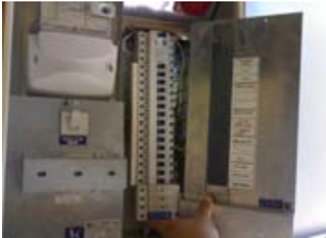
Sähkökeskukseen tulee toinen suojaus joka lopulta leikkaa salaman "turvalliseksi". Kolmevaiheinen suoja kuvassa alimmaisena
