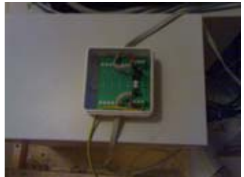
Ylijännitesuoja Rihlaperän ohjaushuoneessa.
