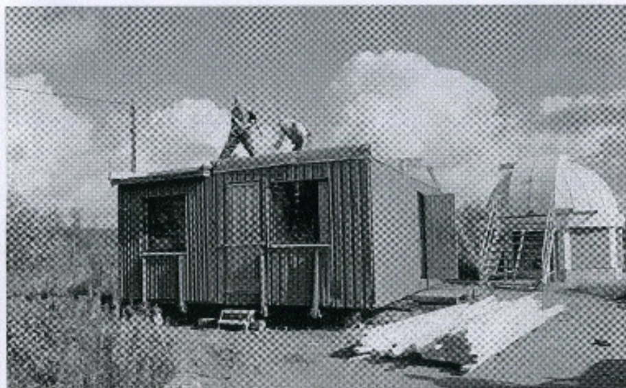
Nyrölään observatorion uusi huoltorakennus asennettiin vanhemman viereen kesän 2001 aikana ja samalla rakennettiin molempia rakennuksia suojaava yhteiskatto. Kuvassa katon rakentaminen on juuri alkanut. Kuva Arto Oksanen.
